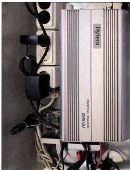
Das hier hochkant montierte DMR-Hytera-Relais RD625 bei DB0LR
